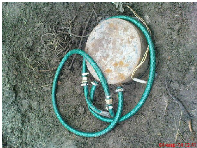
Рис. 2. Вузол закачування холодного носія у вертикально розміщений теплообмінник (свердловина №7(В)).
