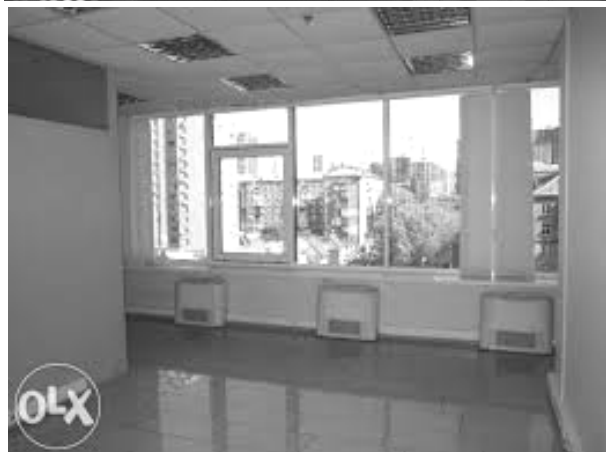
Рис. 8. Система опалення та кондиціювання приміщень на основі обернених фанкойлів у торгово-офісному центрі "Палладіум Сіті".
