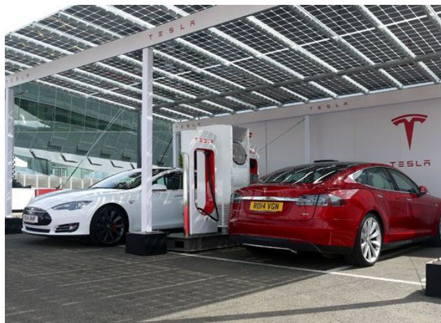
Рис. 13. Зарядна фотоелектрична станція електротранспорту Tesla (США).
