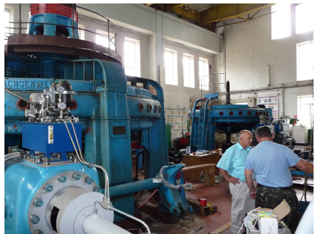
Рис. 3. Машинна зала Сабарівської малої ГЕС (Потужність 1400 кВт, р. Південний Буг, м. Вінниця).
