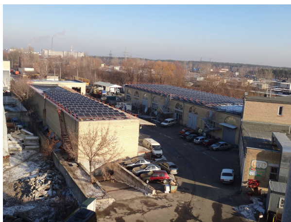
Рис. 2. Загальний вигляд дахової фотоелектричної станції.
